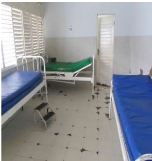
Unidade do paciente incompleta e sem instalação de Gases medicinais.
